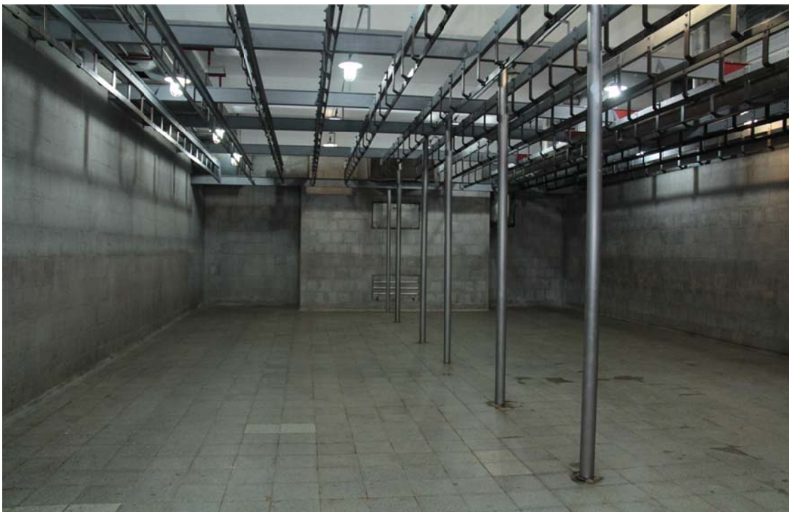
Foto 3. Cámaras para la refrigeración de medias reses. Se puede observar que son de diferentes construcciones.
