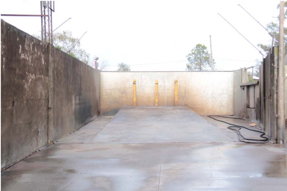
Foto 34. Paredes de mampostería de 3 metros de alto como mínimo. Los caños que están por sobre la pared e inclinados hacia adentro, se utilizan para la desinfección del transporte con una solución de carbonato de sodio al 4%.
