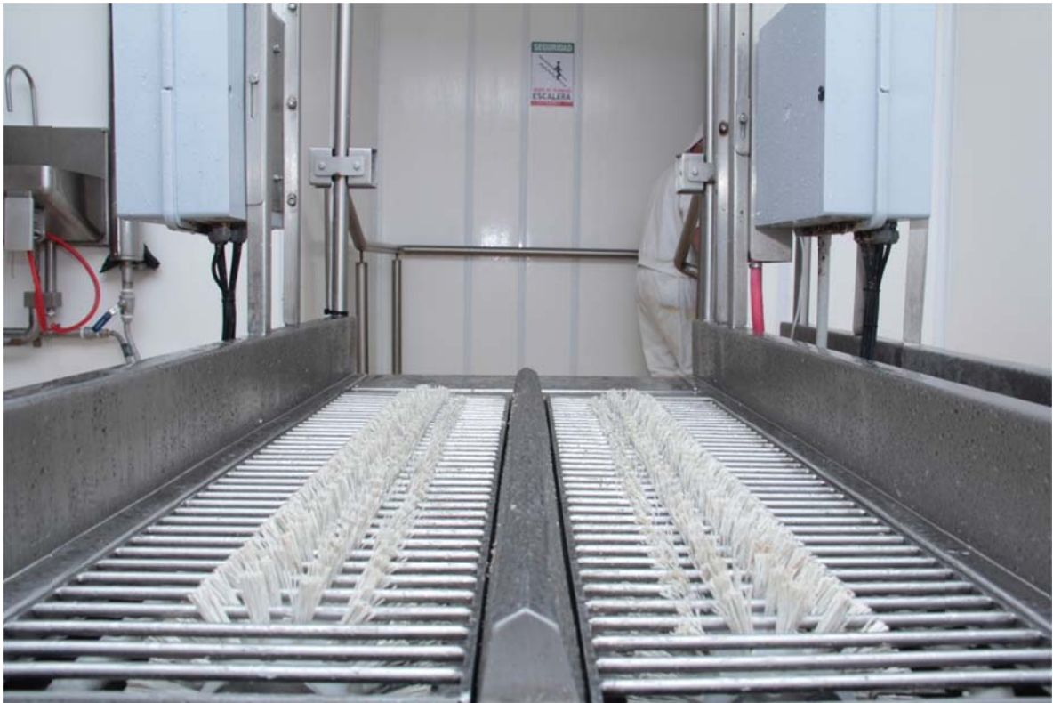
Foto 10. Filtro sanitario de entrada a despostada. Lavasuelas con cepillos giratorios.
