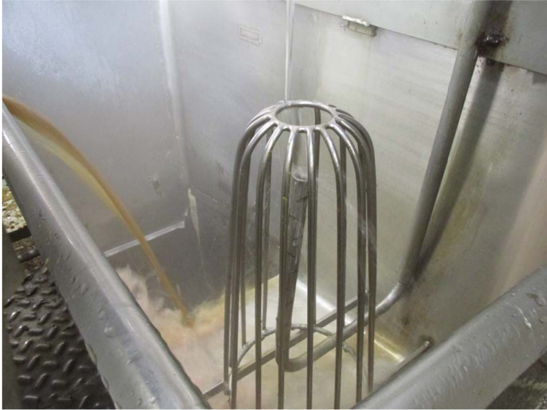
Foto 7. Lavador de mondongos llamado "Paraguas" o "Sombriila". Tira agua desde adentro y desde arriba por una lluvia.
