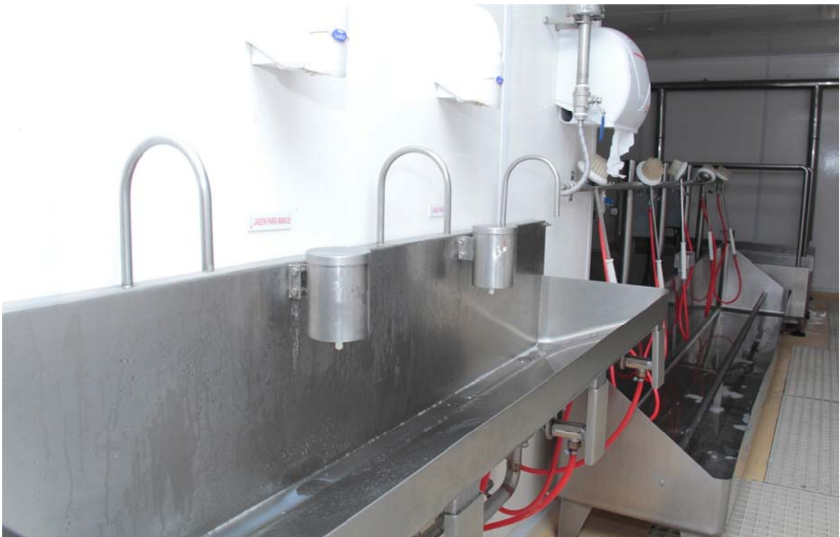
Foto 11. Filtro de entrada a despostada. Se observa el lavamanos, lavabotas y en el fondo el lavasuelas.
